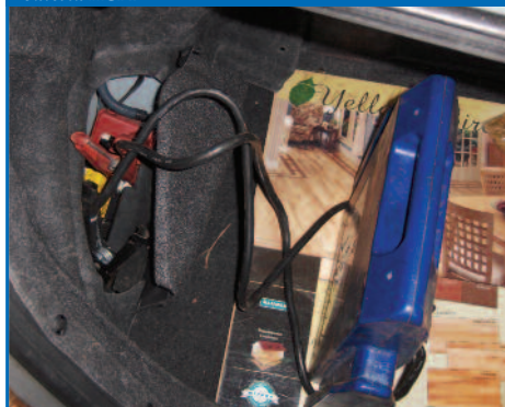
Figura 2: Instalando el paquete de batería en la batería AGM
